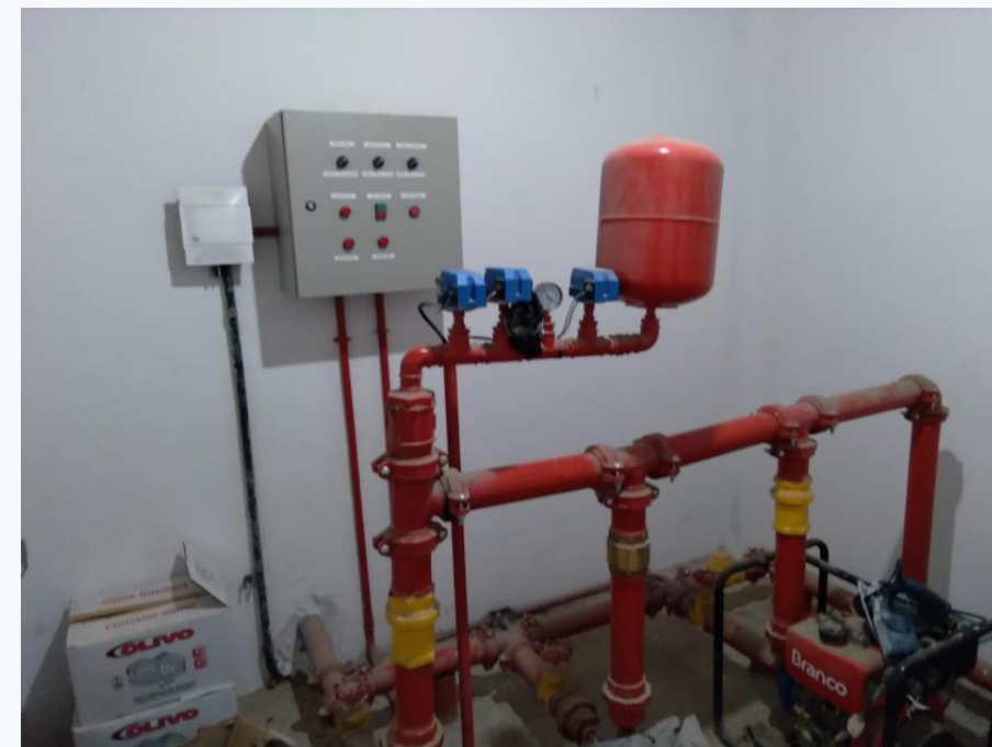
Sistema de bombas instalado
